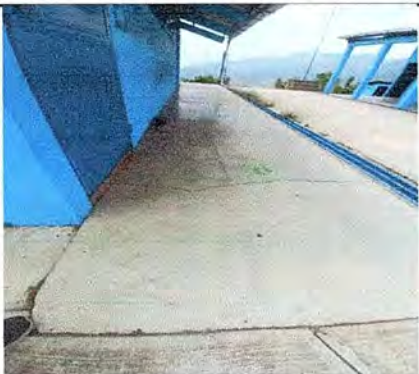
Foto 1: CORREDOR PATIO DEL AULA DETERIORO EN LA TORTA DE CEMENTO
