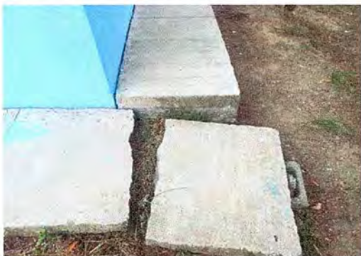
Foto 3: LAS BANQUETAS SE ESTAN PARTIENDO
