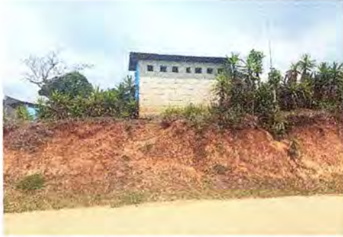
Foto 7: LA BODEGA EXISTENTE, EL MURO SE ESTA DERRUMBANDO
