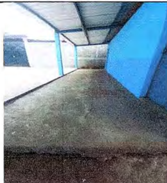
Foto 2: CORREDOR COCINA DETERIORO EN LA TORTA DE CEMENTO
